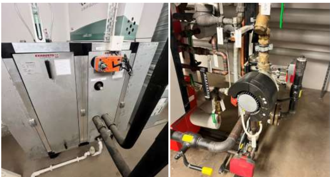
Figure 2 EC fläkt med återvinningsbatteri
