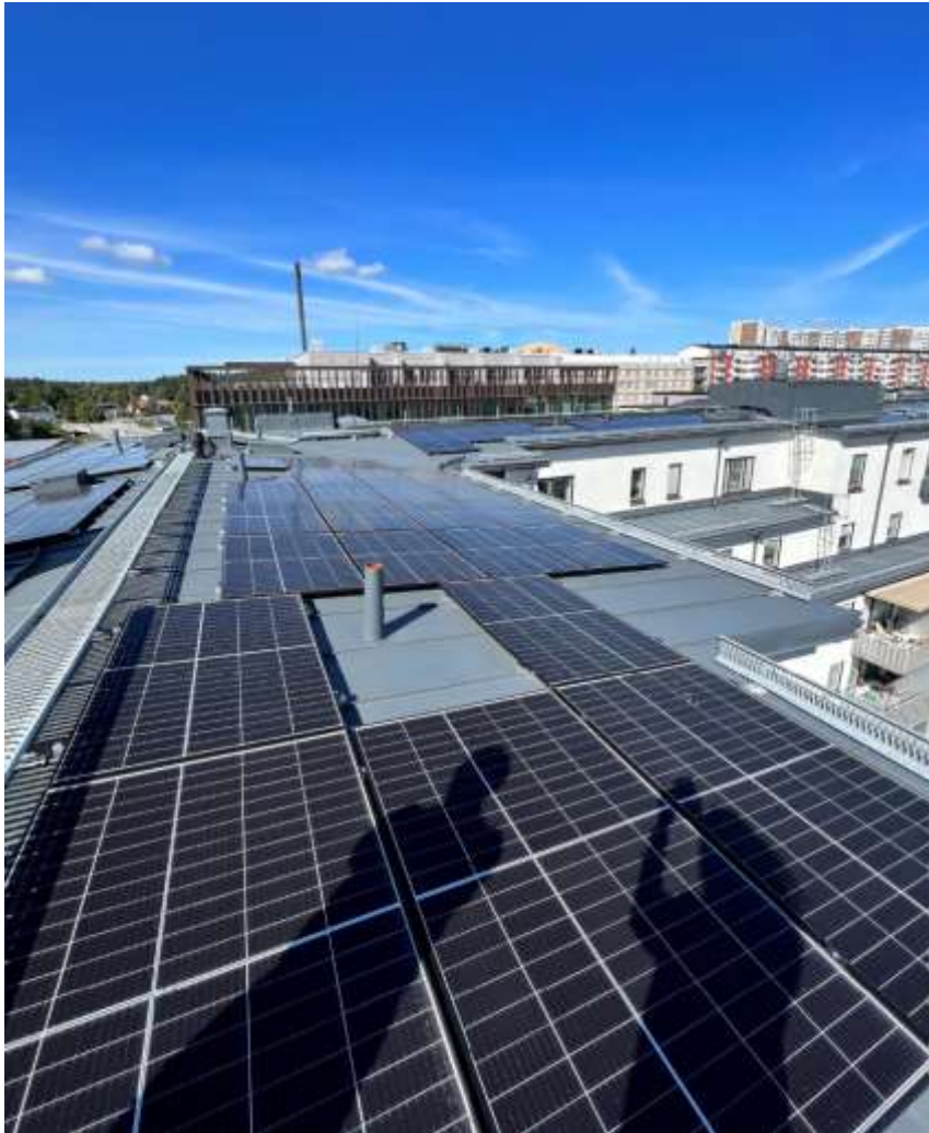
Figure 3 Ny Solcellsanläggning installerad
